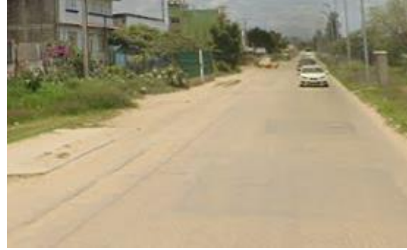
Se aprecia desgaste en la superficie de pavimento, coordenadas 17.1203158, -96.7674579, localidad y municipio de Oaxaca de Juárez.
