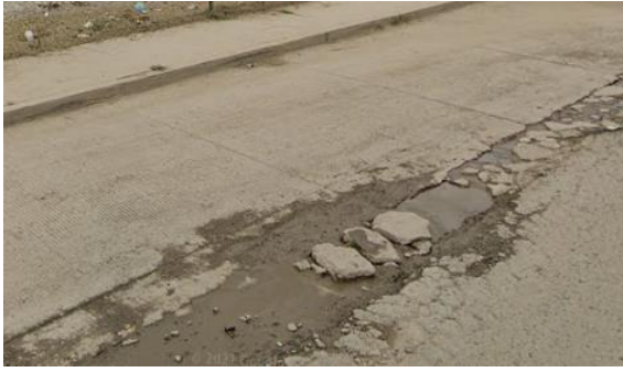
Se aprecia ruptura en el pavimento y baches, coordenadas 17.1267515, -96.7735038, localidad Hacienda Blanca, municipio de San Pablo Etla.
